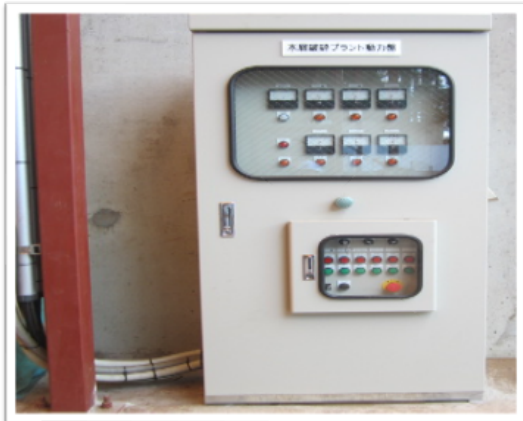
木屑破砕プラント動力盤
